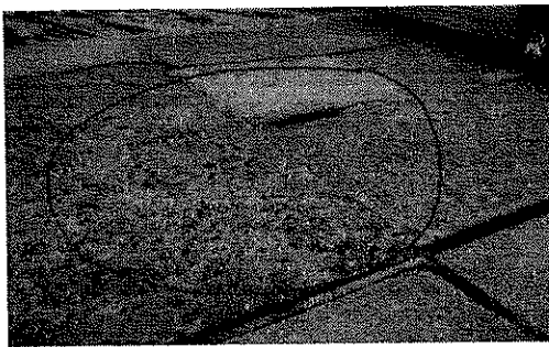
Foto 15. Desgaste Estructural Relevante
