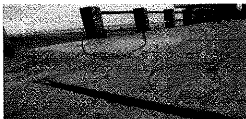
Foto 3. Perdida de Estructuralidad y Reparacion Losa
